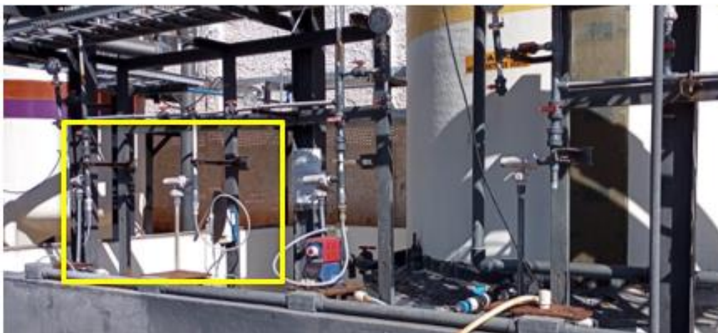
Figura 2- Funcionamento das bombas no supervisório da ETA Cristo Rei
